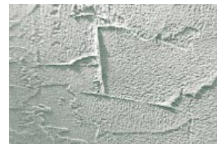
Auf Kalkputz konnen sich auch in feuchten Raumen kaum Schimmelpilze ansiedeln.
